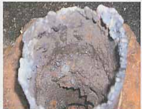
写真2 内面腐食状況
