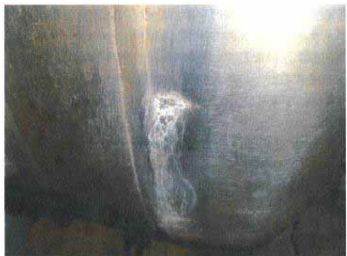
写真 3 漏れ状況 (外部)
