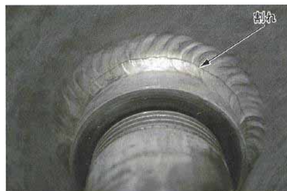
写真2 連続ブロー水入口
