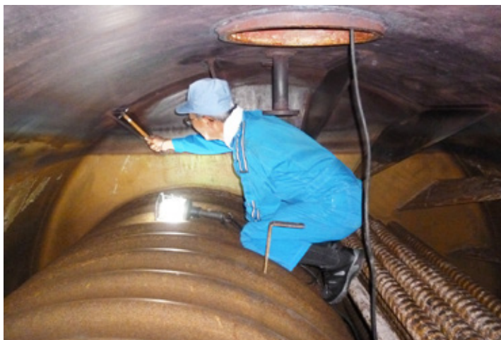
ボイラー性能検査状況
