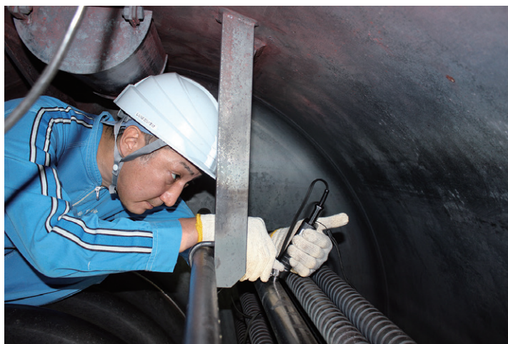
ボイラー性能検査状況
